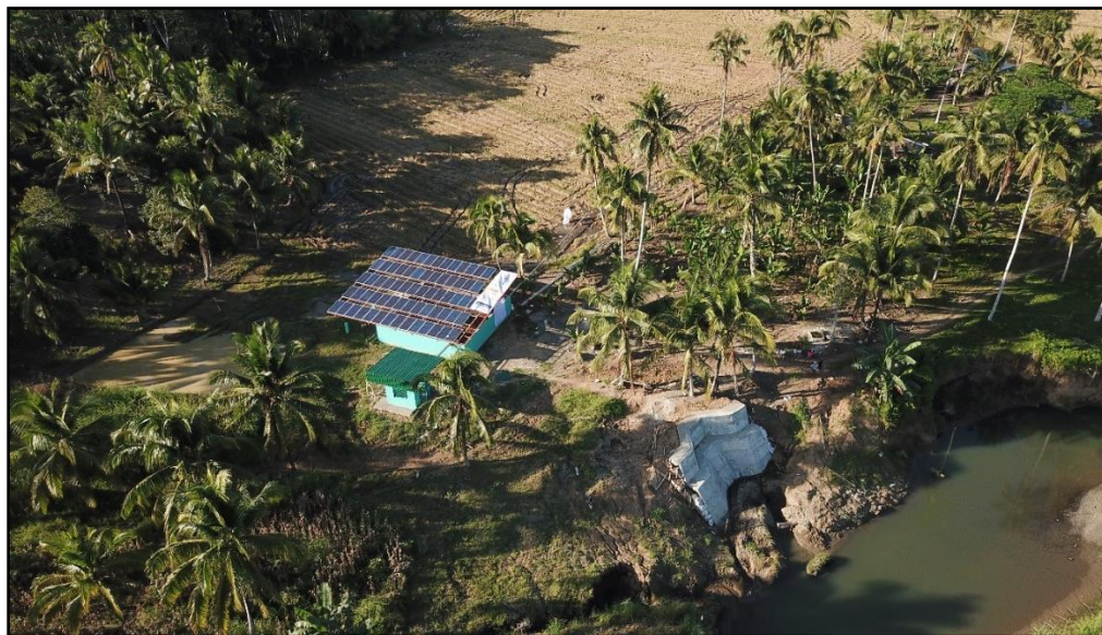
Figure 2. Actual Installed SPIS
